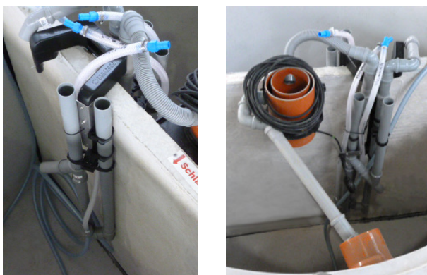
Oben: In einer monolithisch gefertigten 2-Kammer-Grube bereits vormontierte DANGL-BatchPLUS®
